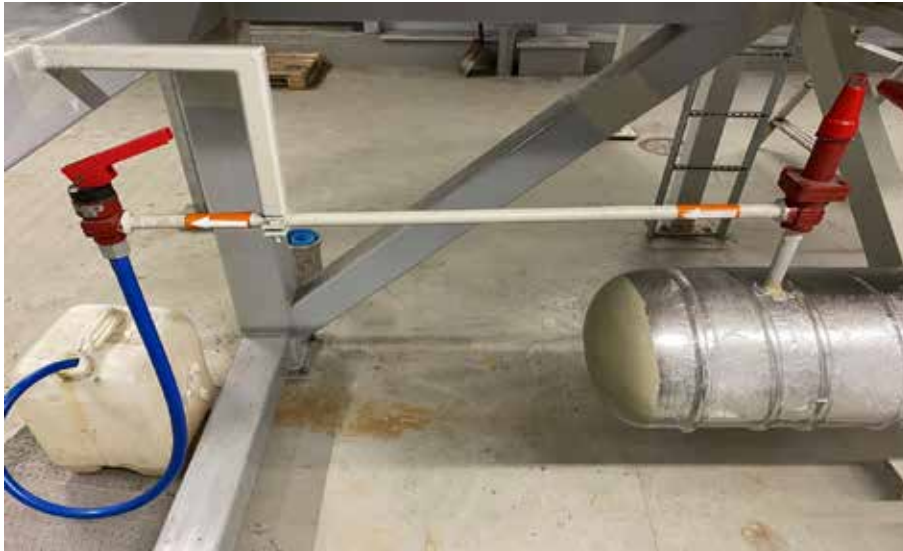
Kuva 8. Esimerkki öljynpoistojärjestelmästä, jossa öljy-yhde olisi hyvä johtaa kauemaksi venttiiliin välittömästä läheisyydestä. Näin voidaan estää mahdolliset roiskeet huoltohenkilön päälle venttiiliä avattaessa (kuva: Jomcon Oy).
