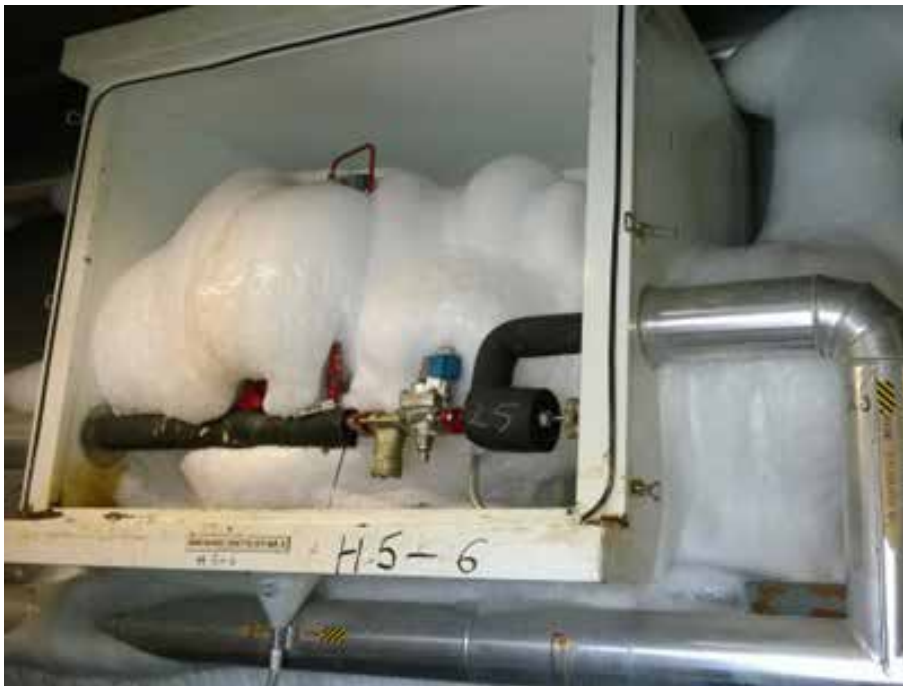
Kuva 9. Esimerkki jäätyneistä kylmälaitoksen komponenteista. Jään irrottamista mekaanisesti tällaisista kohteista tulee välttää laitteiden rikkoutumisvaaran vuoksi (kuva: Jomcon Oy).
