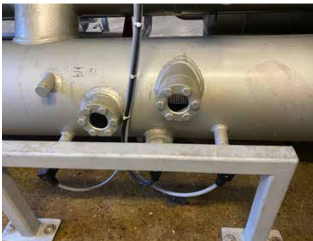
Kuva 11. Kompressorin anturien ja lämmitysvastusten suoja ulkopuolisia iskuja vastaan (kuva: Jomcon Oy).
