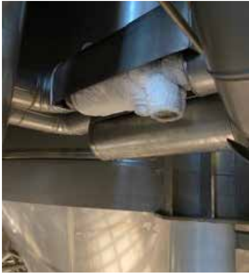
Kuva 10. Ammoniakkikylmälaitoksen jäänyt suodatin ja syöttöventtiili (kuva: Jomcon Oy).
