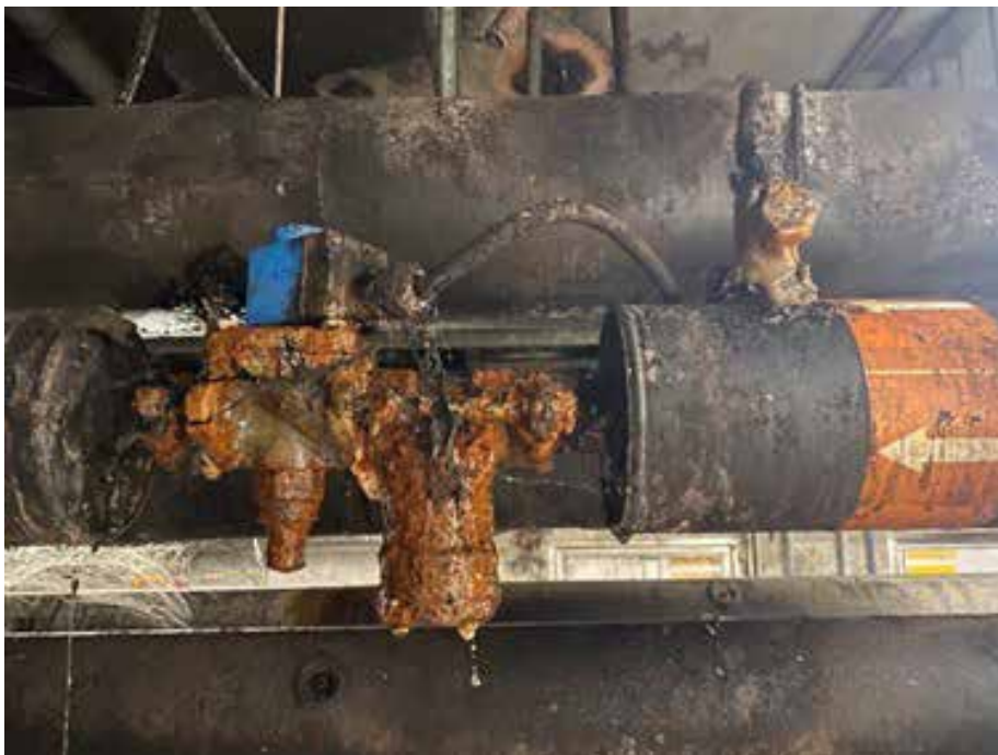
Kuva 5. Eristetyn kotelon sisällä vettynyt ja korrodoitunut laitoskomponenttipaketti (kuva: Jomcon Oy).
