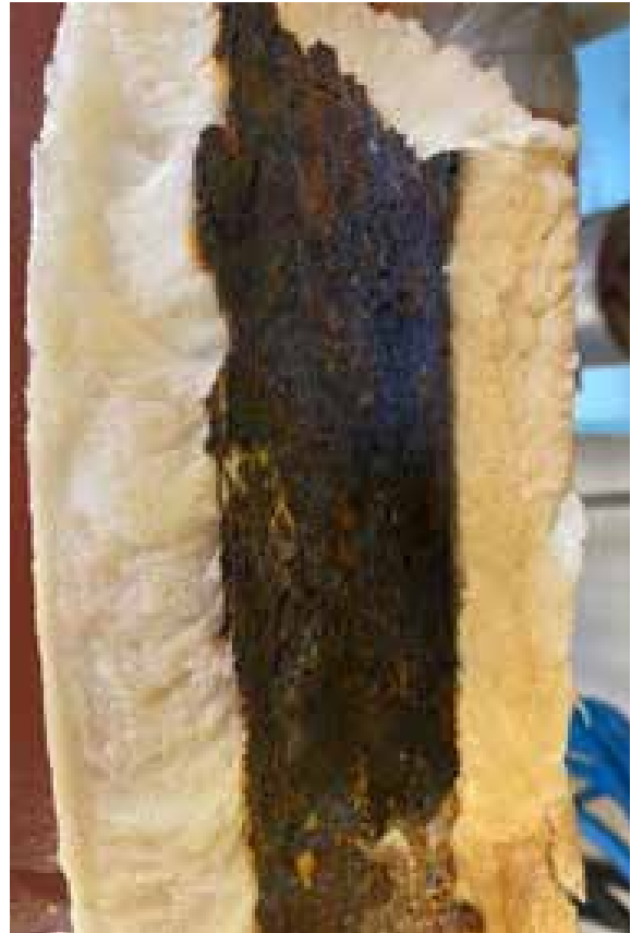
Kuva 4. Nestelinjasta irrotettu uretaanieriste (sama putki kuin kuvassa 3 (kuva: Jomcon Oy).
