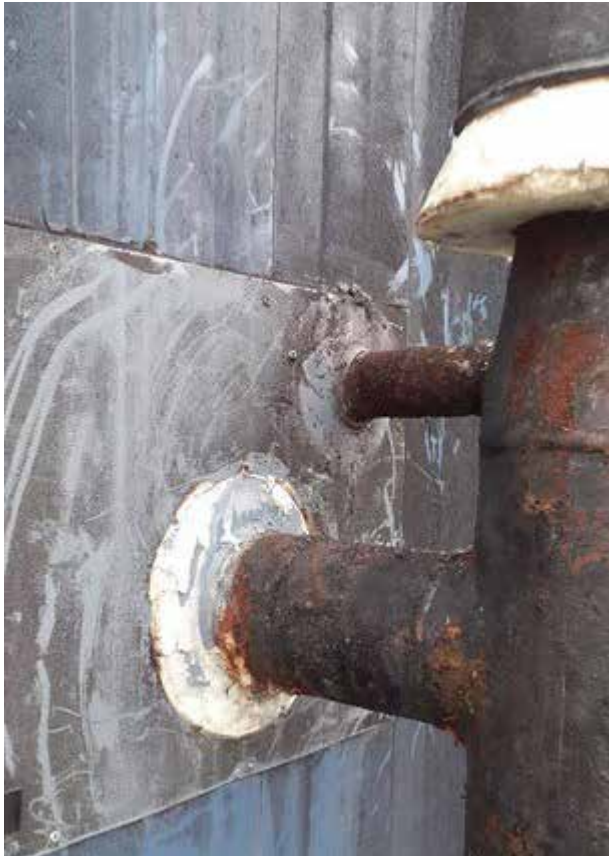
Kuva 3. Vettyneen polyuretaanieristeen alla syöpynyt nestelinjan putki (kuva: Jomcon Oy).
