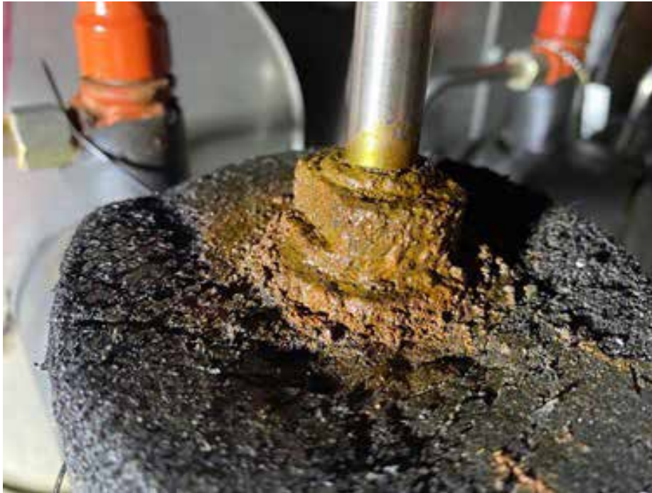
Kuva 6. Ammoniakkilaitoksen sulkuventtiili, josta on puuttunut suojarahattu.
