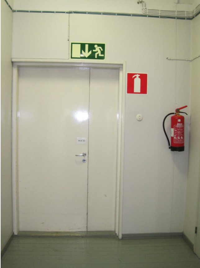
Kuva 4. Käytävätilaan, uloskäynnin läheisyyteen sijoitettu jauhesammutin on merkitty näkyvällä kyltillä.
